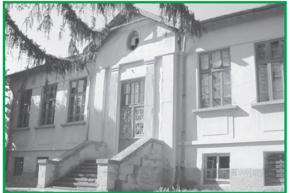
Сградата на училището пустее, днес от нея се използва само салонът в приземния етаж.
